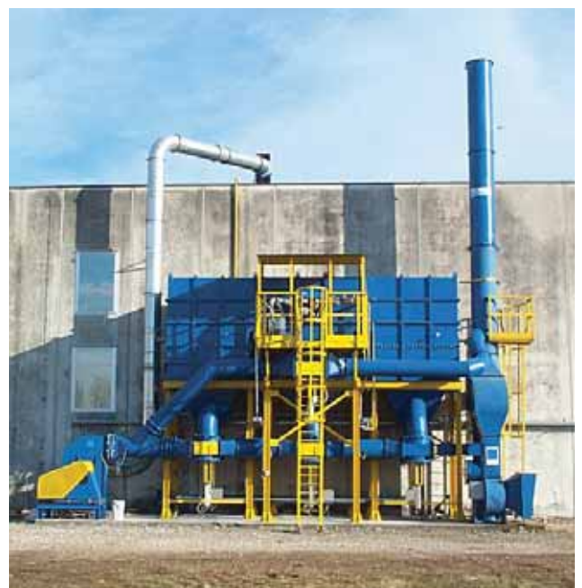
Impianto di combustione di tipo rigenerativo da 9.000 Nm 3 /h Regenerative incinerator 9,000 Nm 3 /h
