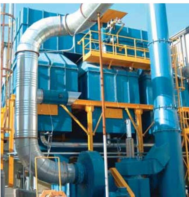
Impianto di combustione di tipo rigenerativo da 30.000 Nm 3 /h Regenerative incinerator 30,000 Nm 3 /h
