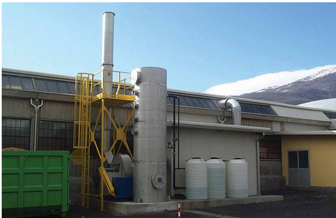
Scrubber per abbattimento ad umido da 10000 Nm 3 /h / Scrubber for wet absorption 10000 Nm 3 /h
