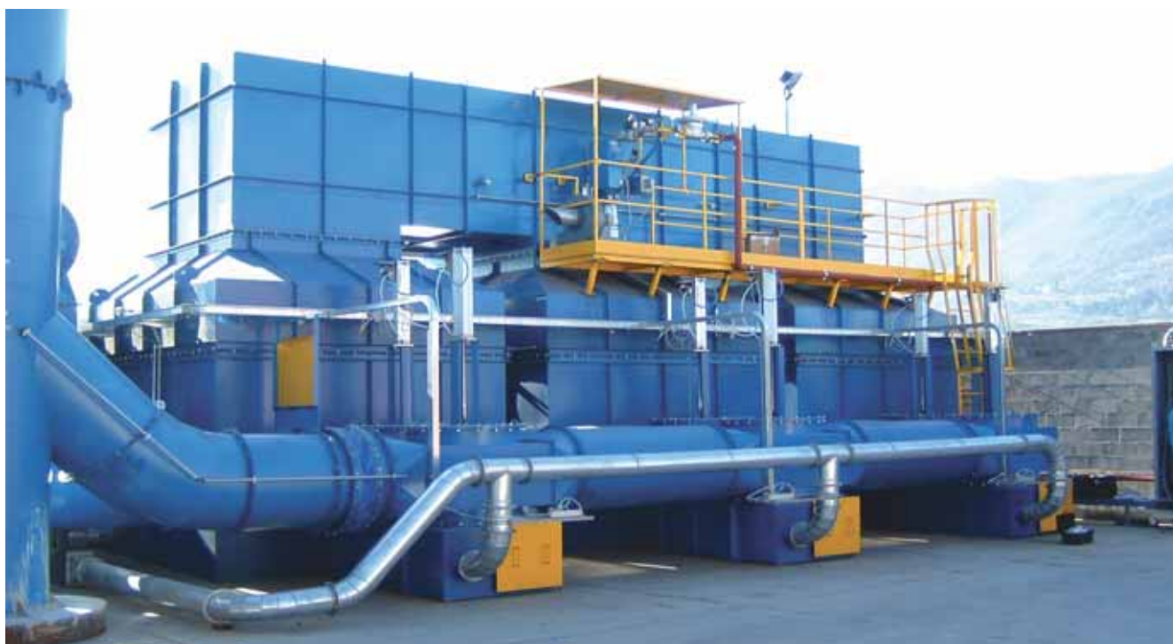
Impianto di combustione di tipo rigenerativo da 25.000 Nm 3 /h
