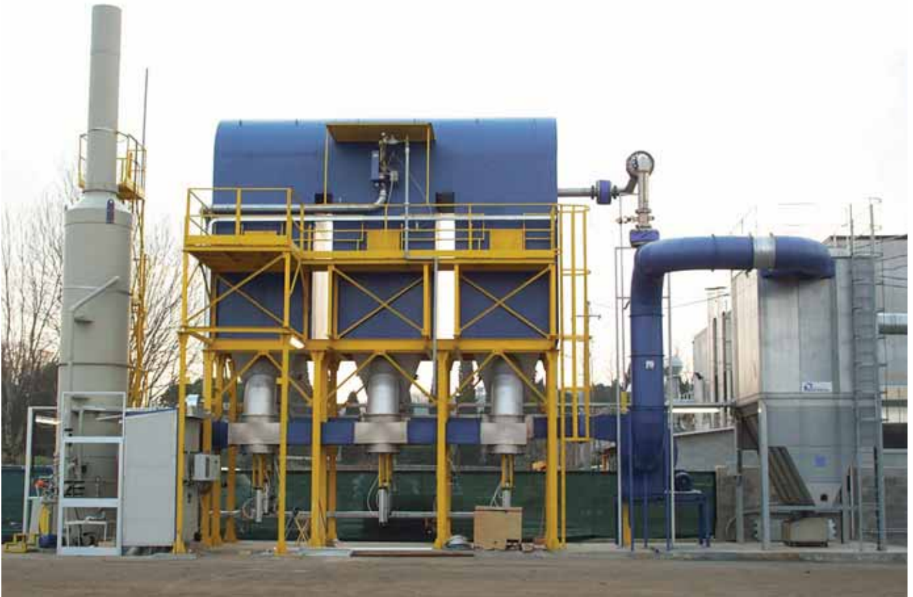
Impianto di combustione di tipo rigenerativo da 10.000 Nm 3 /h
