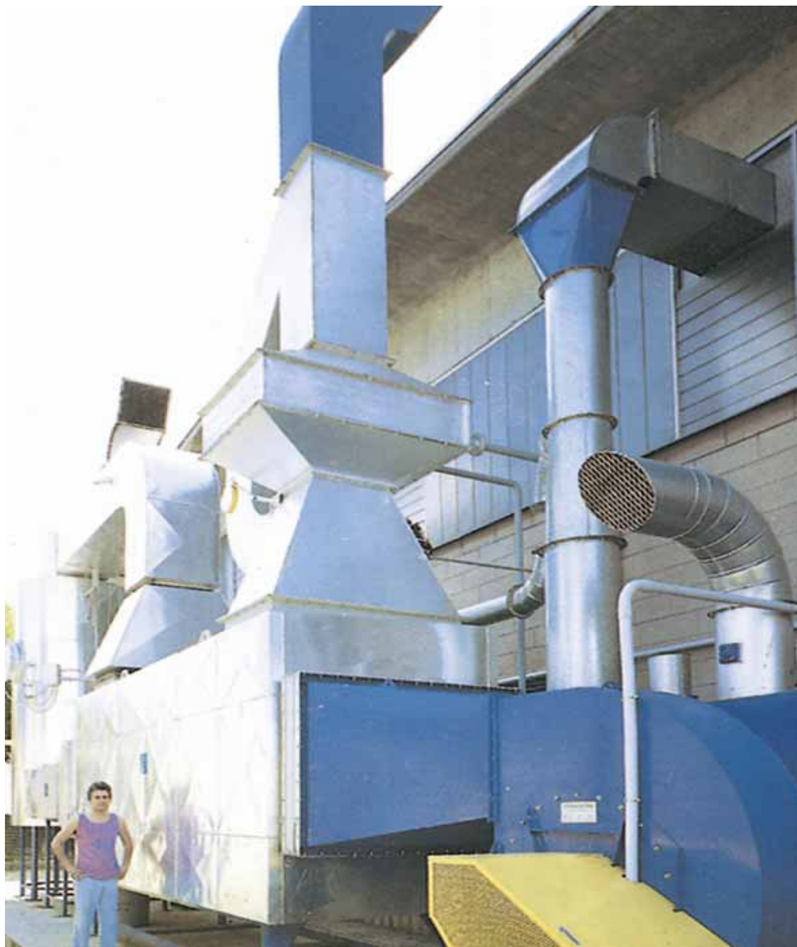
Impianto di combustione catalitica da 10.500 Nm 3 /h installato presso una ditta che plastifica carta e cartone.
