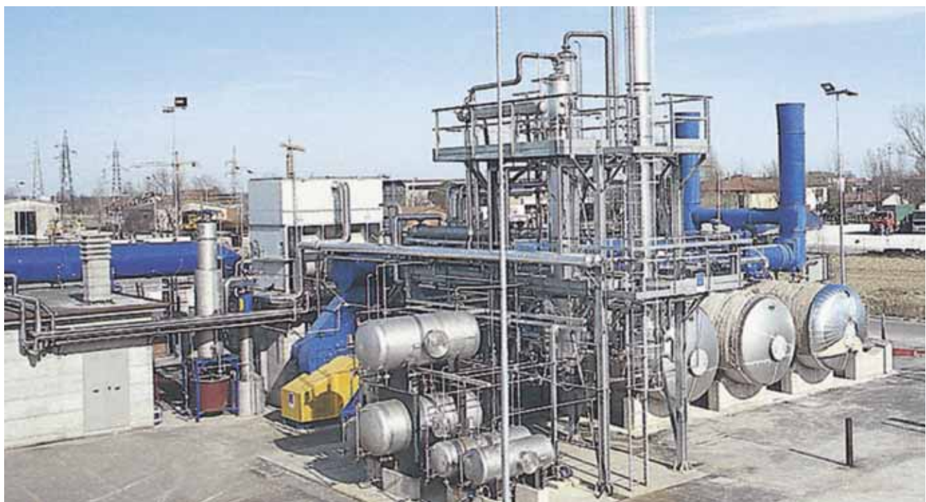
Lato distilleria di impianto recupero solvente a 6 adsorbitori
