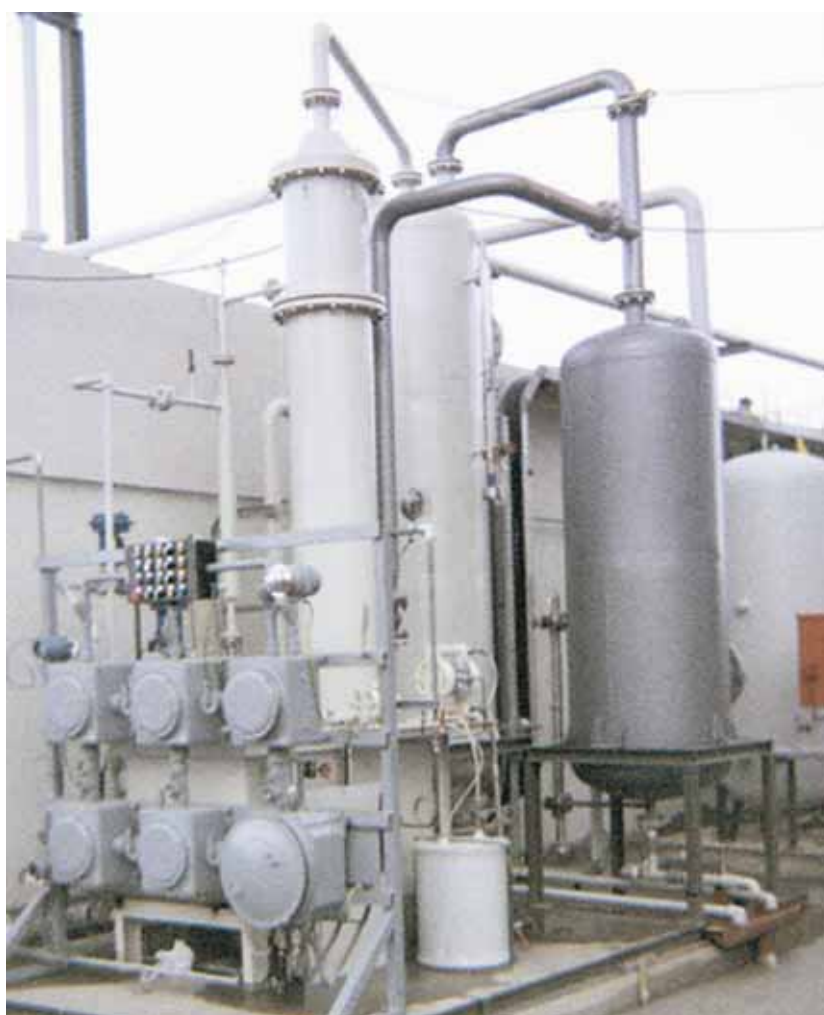
Impianto "Scrubber" di abbattimento H 2 S con colonna di assorbimento e batteria di filtri a carbone attivo. Portata d'aria: 1.000 Nm 3 /h.
